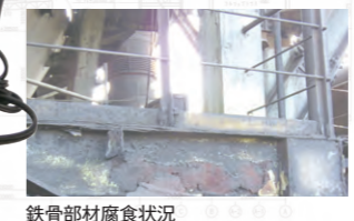
鉄骨部材腐食状況
