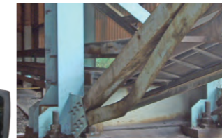
鉄骨部材変形状況
